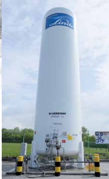
Herose-Armaturen im Einsatz: Der große Sauerstofftank auf dem Firmengelände.
